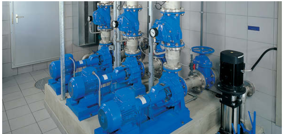
Rohwasserpumpen in Biberbrugg
