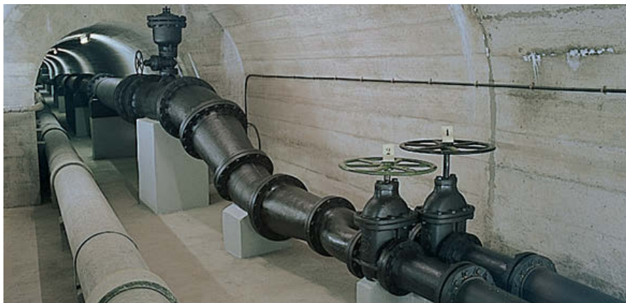
Wasserleitung durch den Teilstock Thalwil
